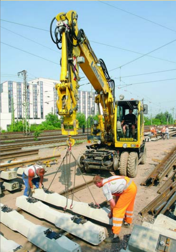
Zur hohen Auslastung von Zweiwegebaggern trägt auch ihr Einsatz bei vorbereitenden Arbeiten bei.
