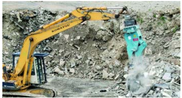
360° Rotation für mehr Wirtschaftlichkeit: Die Bento-Abbruchzange des Typs BFP16 im Einsatz auf dem Recyclinghof von Ferdinand Barnhausen in Möhnesee.
