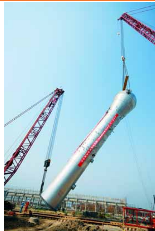
UNTERSTÜTZUNG: Das Nachführen der 400 t schweren Kolonne in der Raffinerie übernahm ein CC 2500 mit einer maximalen Tragfähigkeit von 450 t.
