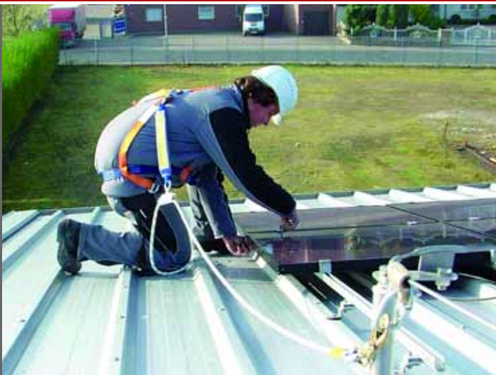
ANGESCHLAGEN: Auch für Arbeiten auf Gebäuden ist eine Sicherung wichtig.
