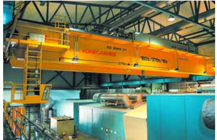
Kraftwerkskran: Zwei vergleichbare Krananlagen wird Konecranes im kommenden Jahr an die chinesische Dongfang Electric Co. Ltd. für die Montage von Turbinen liefern.
