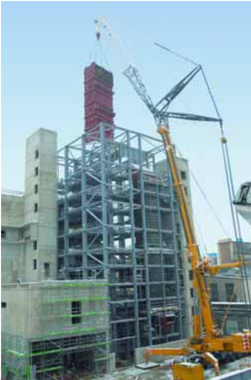
Schmidbauer-Job in Augsburg: Der 700-t-All-Terrain-Kran von Terex wurde eingesetzt, um die unterschiedlich großen Kraftwerkselemente aufzustellen.
