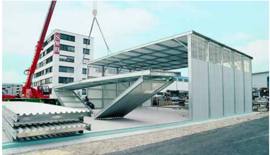
Zur schnellen Truppe gehörend: Die Systembauhalle Transfer 2000 kann innerhalb von 24 Stunden aufgebaut werden.
